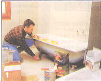
Устройство ванной начинают с составления детальной планировки, рациональность которой можно проверить, временно разместив в соответствии с этой планировкой сантехническое оборудование.
