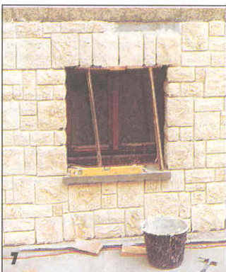
При облицовке перемычки над оконным проемом следует обратить внимание на симметричность кладки — левая и правая части перемычки должны быть уложены зеркально от середины проема. Уложенные камни поддерживает доска, подпертая двумя отрезками брусков.
