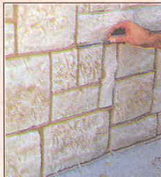
Швы расшивают за один прием на участках площадью в 1 м 2 . Возможные наплывы разглаживают металлической расшивкой, равномерно смещая слегка подсохший раствор к краям.
