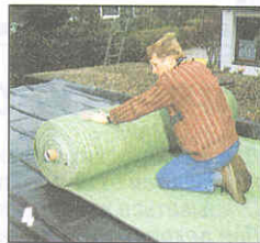
Расстилают на крыше дренажный мат шириной 200 см. Мелкие дренажные каналы расположены снизу, что обеспечивает сток воды.
