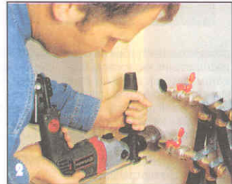
Трубы монтируют, пока стены еще открыты, хотя бы с одной стороны. На фото показан вырез отверстия для трубы.
